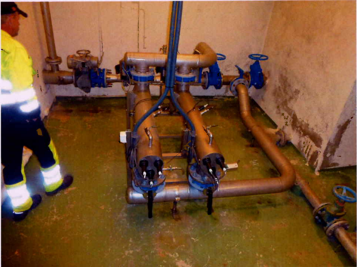
Bilde 4 viser UV-anlegget i vannbehandlingshuset.
