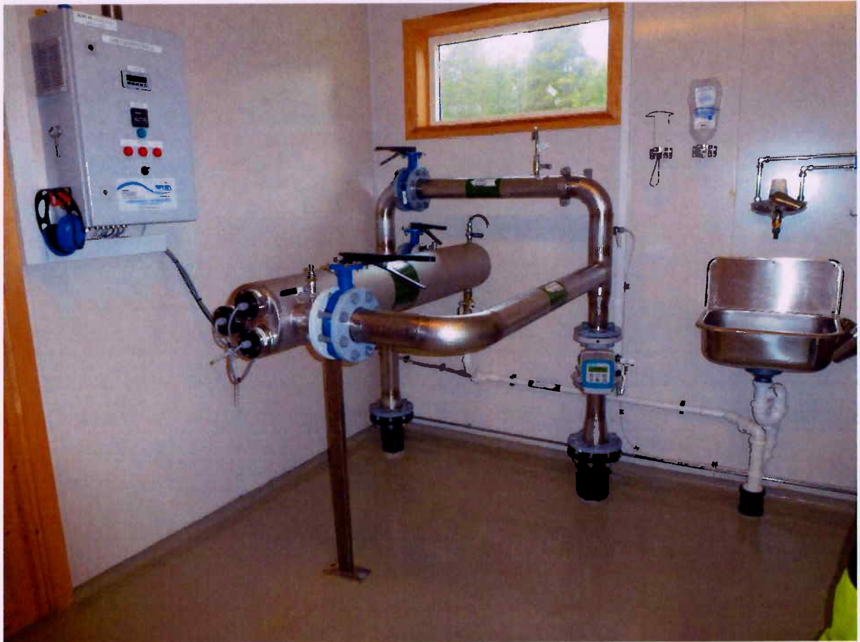
Bilde nr 6, viser UV-anlegget
