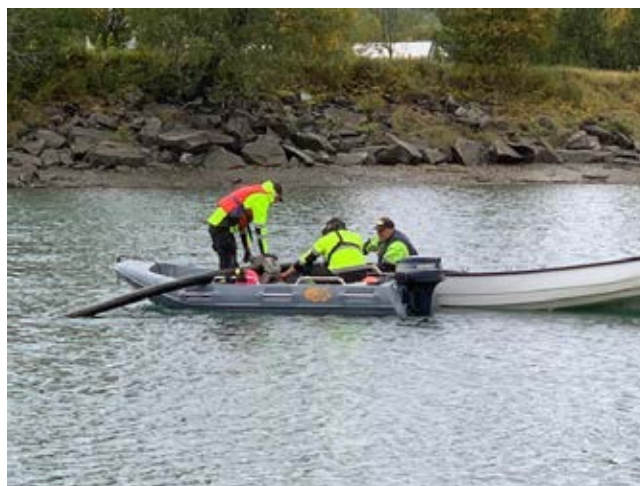
vLedningsbrudd i elvekryssingen mellom Dokmo og Soløy
