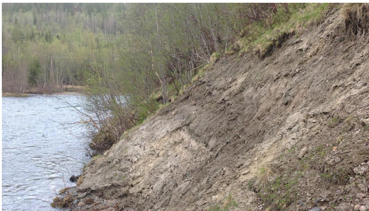
Figur 5.13 Bilde S33: Stor utglidning. Rundt 30 meter bred og 15 meter i høyden
